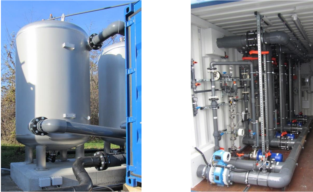
Abbildung 8: Ozonreaktor I (links) und assoziierte Verrohrung sowie Ozoneintragungssystem (rechts)
