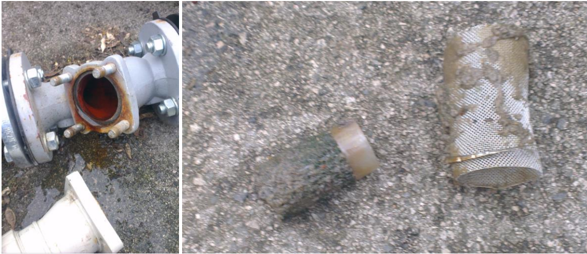
Abbildung 22: Foto links: Einbau GAK-Schmutzfänger, Foto rechts: Sieb von Wasserzähler (links) und belegter GAK-Schmutzfänger (rechts)
