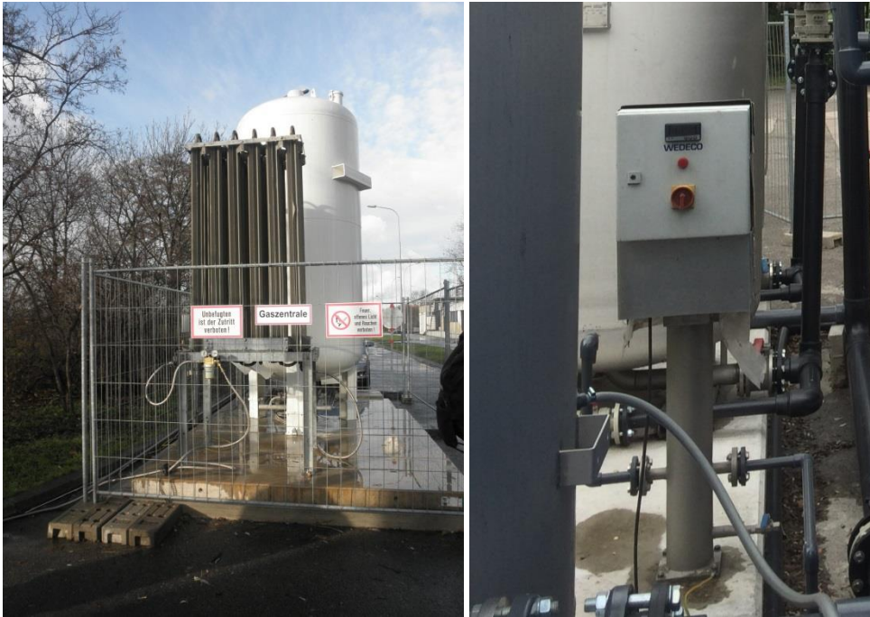
Abbildung 9: links: Sauerstoffanlage, bestehend aus Sauerstoff-Behälter (im Hintergrund) und Sauerstoff-Verdampfer (im Vordergrund); rechts: Restozonvernichter
