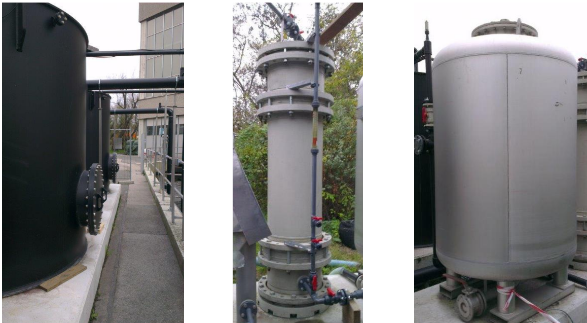
Abbildung 12: Ozon-Nachklingbehälter, Anthrazitfilter und Aktivkohle-Druckfilter (nachgeschaltet), von links nach rechts
