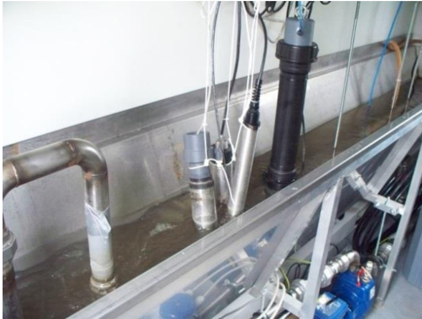
Abbildung 14: Messwanne im Messcontainer mit installierten Online-Sonden (Messstelle „IN“)
