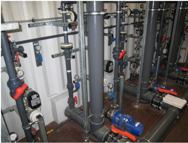
Abbildung 10: Rohrleitungsführung im Verrohrungscontainer mit den 4 Strängen, welche zu den Ozon-Reaktoren führen
